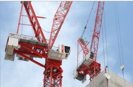
Krane Drehzahlgeführter Start- und Stoppbetrieb am Kranz; Seilzugantrieb mit hohem Stellbereich der Hebe- und Senkgeschwindigkeit
