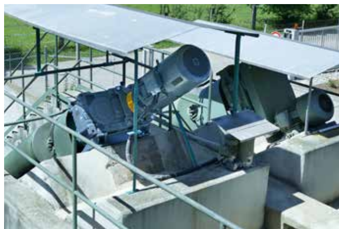
Neuer Antrieb mit Stahlkonstruktion
