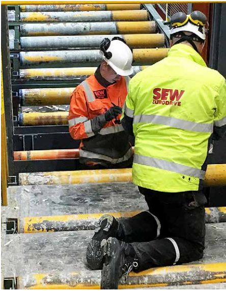
▲ CDM®-asennuskannan laitteiden kartoitusta sahalla.
