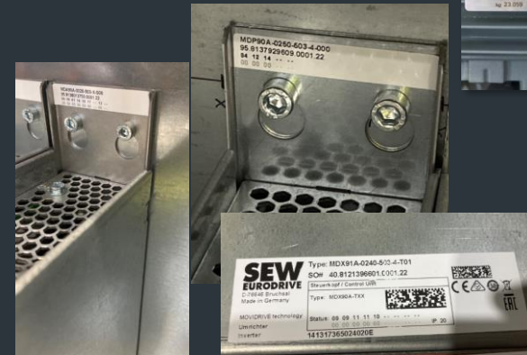
Targhette inverter in quadro elettrico
