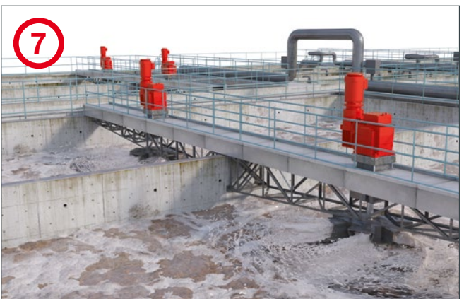
Belebungsbecken mit Oberflächenbelüfter Unser Lösungsbeispiel: Applikationsbaureihe X.../HA mit verlängertem Lagerabstand und thermisch optimiertem Getriebegehäuse.
